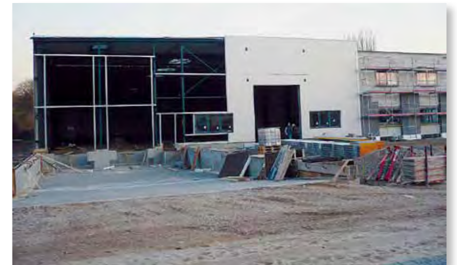
Die Arbeiten am Neubau sind in vollem Gange: Im Frühjahr 2012 erfolgt die Einweihung für das 1.500 Quadratmeter große Logistik-, Lager- und Versandzentrum. 1.000 Quadratmeter sind zusätzlich für Büros und Schulungsräume vorgesehen. Es sind Räumlichkeiten für Händlerseminare, die praktisches Schweißstraining beinhalten, und für den zentralen deutschlandweiten Kundendienst vorgesehen.
